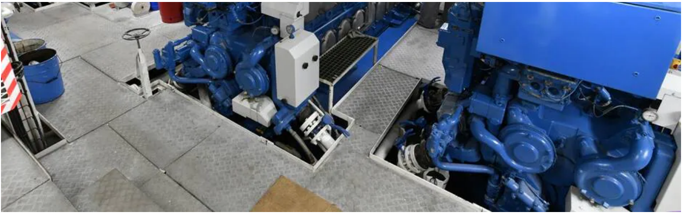
Les générateurs du Manapany fournissent toute l'énergie du bord. | THIERRY CREUX / OUEST-FRANCE
