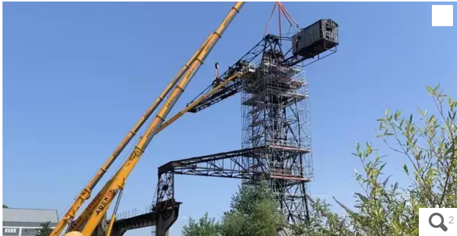
Symbole du passé industriel, portuaire et ouvrier de Nantes, la Grue noire va connaître une vraie cure de jouvence. Au cœur de la Cale Dubigeon, aux Docks de Chantenay, elle est en cours de démontage depuis ce mardi 30 août. © Photo Ville de Nantes
