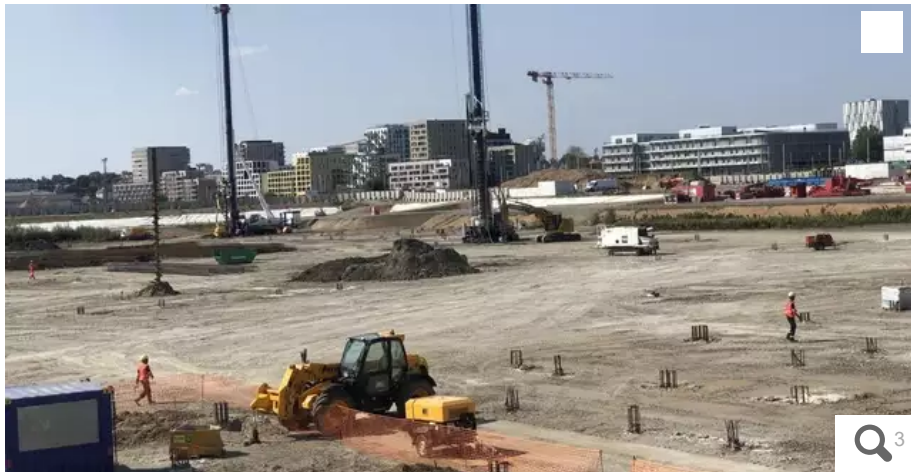
Vue du chantier. À gauche, les émergences métalliques des premiers pieux qui sont plantés et serviront de fondations profondes aux bâtiments. Au second plan, les deux grandes machines à pieux. © Ouest-France
