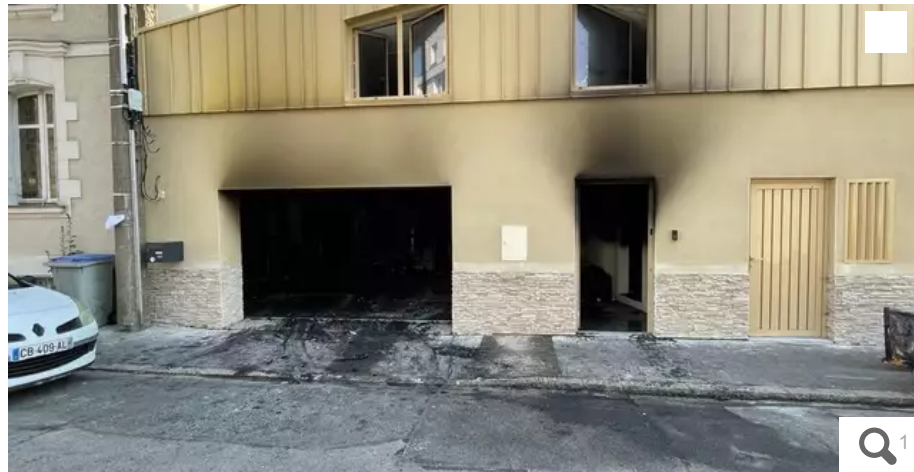
Les dégâts sont visibles depuis la rue de la Bourdonnais. © Photo PO-JM Cornuaille
