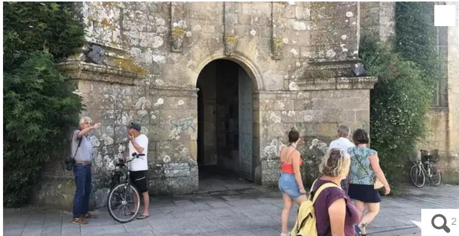
Après un nettoyage de la façade visée par le tag « Tout raser comme les menhirs », il reste néanmoins des traces bleues sur l'église Saint-Cornély à Carnac. © Ouest-France
