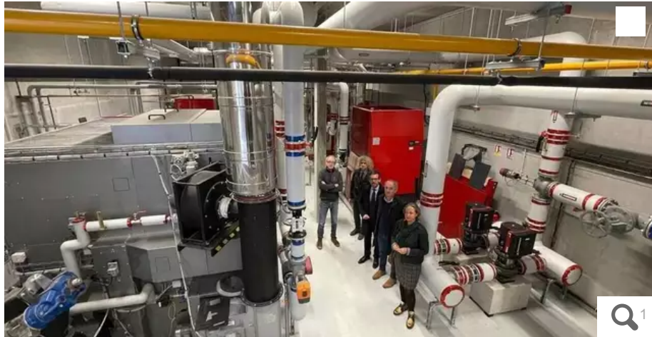
La chaufferie bois installée à Kerdroual permet d'alimenter en chauffage, entre autres, le collège Jean-Paul-II, le centre pénitentiaire, les serres municipales de Lorient, l'Ehpad Ter et Mer, le Pôle municipal de Kerdroual et la future cuisine centrale. © Archives Ouest-France
