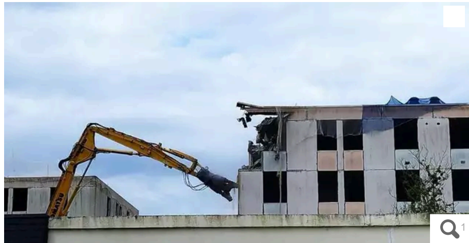
La première phase de démolition de la résidence de Bois Pins a démarré ce mardi 21 mai 2024. Elle concerne trois des cinq immeubles construits en 1971. La deuxième phase de travaux est prévue cet automne 2024. © Ouest-France
