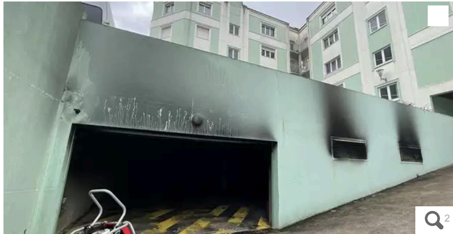
Au 5, rue Vaucanson, à Nantes, une voiture a pris feu dans un parking souterrain, ce dimanche 14 juillet, dégageant d'importantes fumées dans les parties communes de l'immeuble. © OUEST-FRANCE
